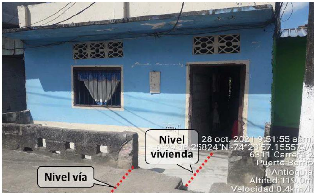
Figura 2. Diferencia de nivel entre la vía (carrera 3ra. y piso de la vivienda). 20
